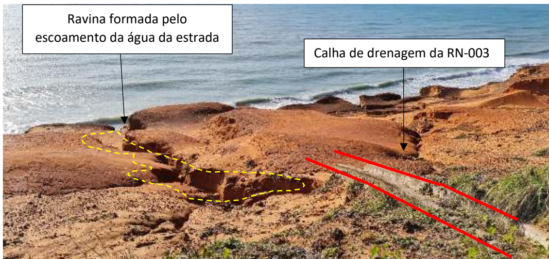
Figura 87: Calha de drenagem da RN-003 lidando com direcionamento da água para a borda da falésia, no fim da calha formação de ravina.
