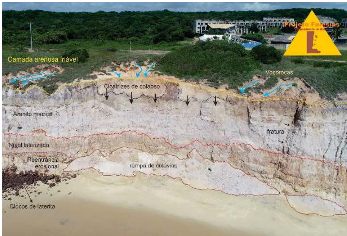
Figura 27: Elementos e processos erosivos em Falésia de Barra de Tabatinga – RN.
